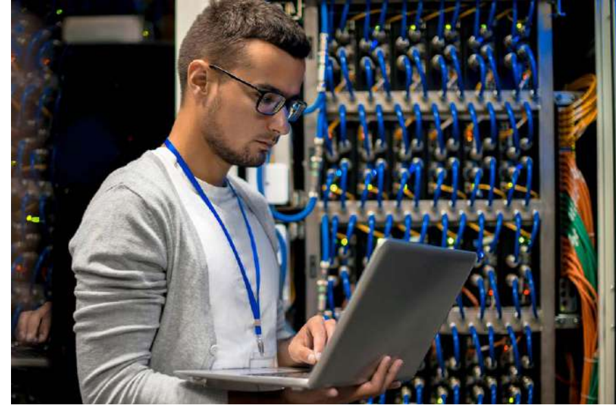
Technicien réseau à l'hôpital
